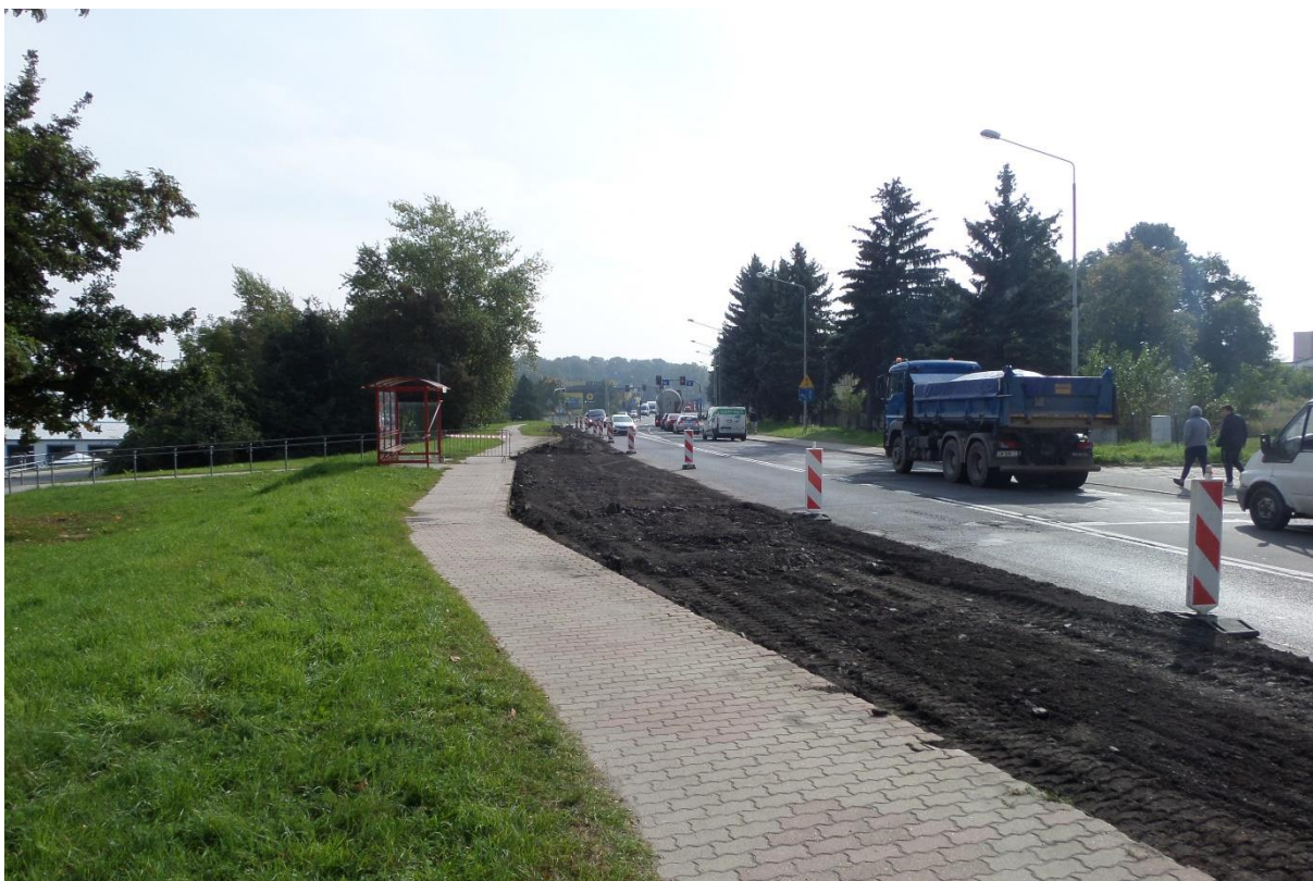
Usunięta warstwa ścieralna z części jezdni – zatoki autobusowej (stan na dzień 29.09.2021 r.)
