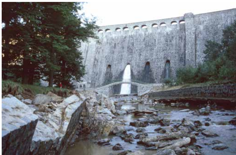
Zniszczenia muru oporowego w korycie Bystrzycy poniżej zapory po powodzi w 1997 r. (fot. M. Furmankiewicz)
