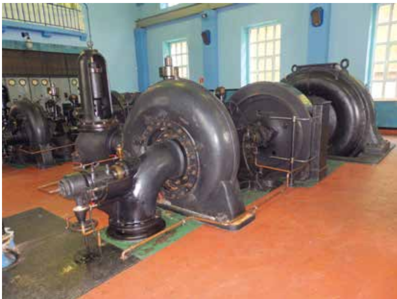
Wnętrze elektrowni wodnej w Lubachowie (fot. W. Rośkowicz)
