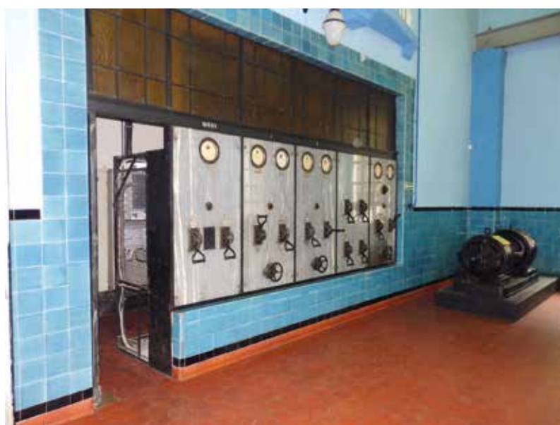
Wnętrze elektrowni wodnej w Lubachowie (fot. W. Rośkowicz)
