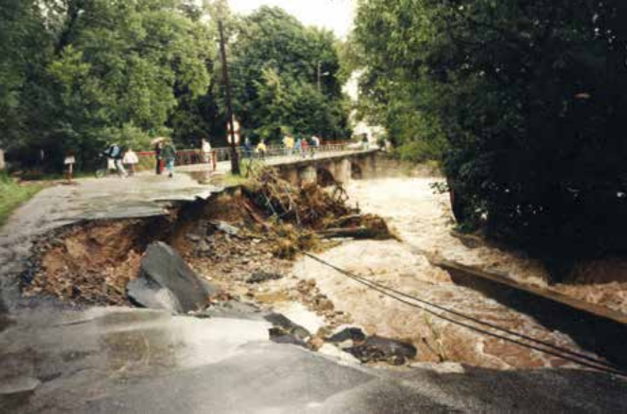
Most w Kraszewicach podczas powodzi w 1997 r. (fot. A. Dobkiewicz)
